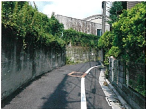
北東の狭あい道路と老朽化した擁壁
